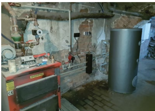
Przed modernizacją kotłowni
